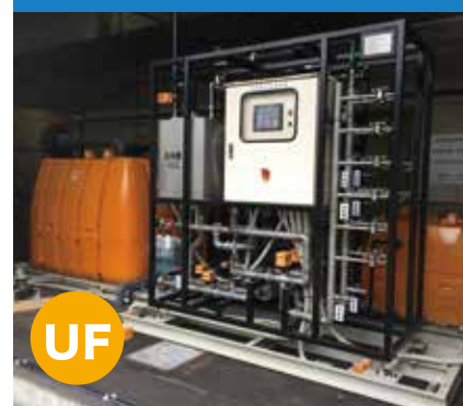
蒸発処理装置の処理効率向上 (前処理による多量混入油分除去)
