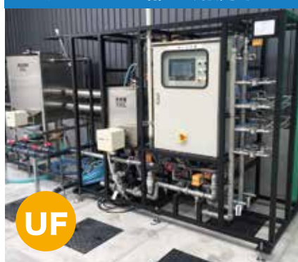
新工場における省エネ化 (濃縮循環ポンプのみの処理エネルギー)
