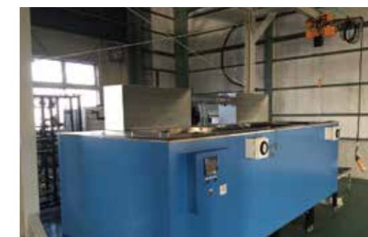
アルカリ脱脂洗浄装置(探傷検査前)
